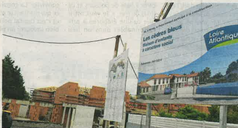
La première pierre a été posée symboliquement jeudi 6 juin, mais les travaux sont déjà bien avancés.
